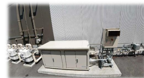
NewPA 設置現場
