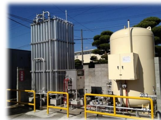
空温式ベーパライザー 及び 2.9t 縦型バルク貯槽
