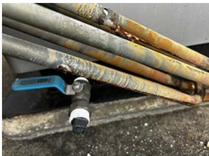
ヒーターの腐食
