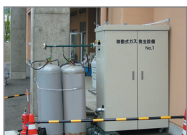
新潟中越沖地震 老人福祉施設
